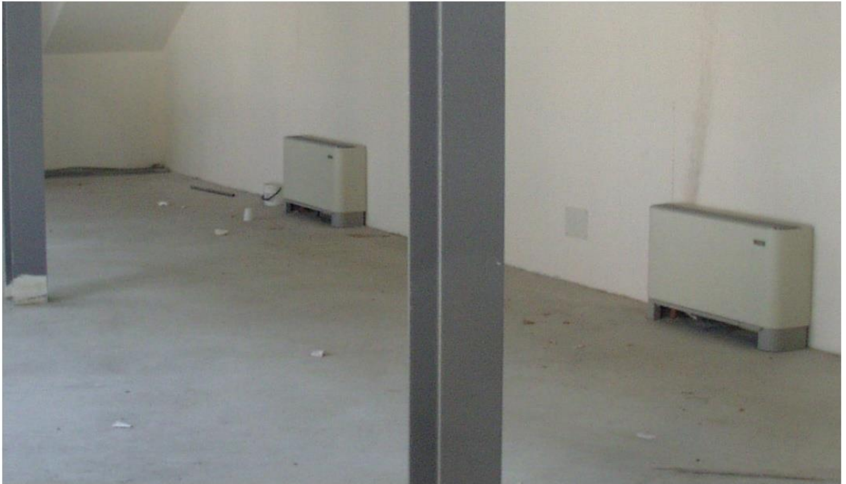
Terminali per riscaldamento e raffrescamento
